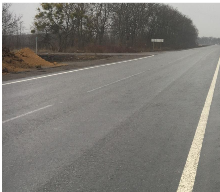
Рис. 5.12 – Загальний вигляд поверхні покриття з ЩМА-20 на ділянці автомобільної дороги Р-46 Харків – Охтирка після трьох років експлуатації
