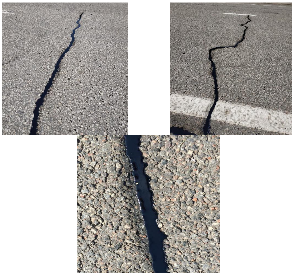
Рисунок 5.12 – Загальний вигляд тріщин відразу після герметизації без напуску герметика на поверхню асфальтобетонного покриття
