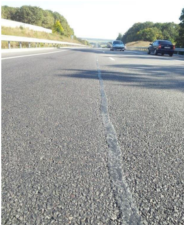
Рисунок 5.15 – Загальний вигляд загерметизованої тріщини через дві доби після герметизації
