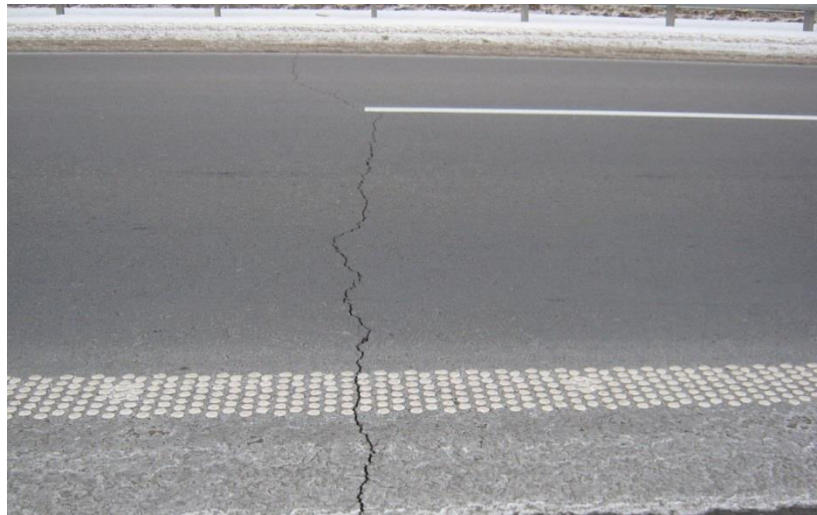
Рисунок 1.1 – Поперечна температурна тріщина
