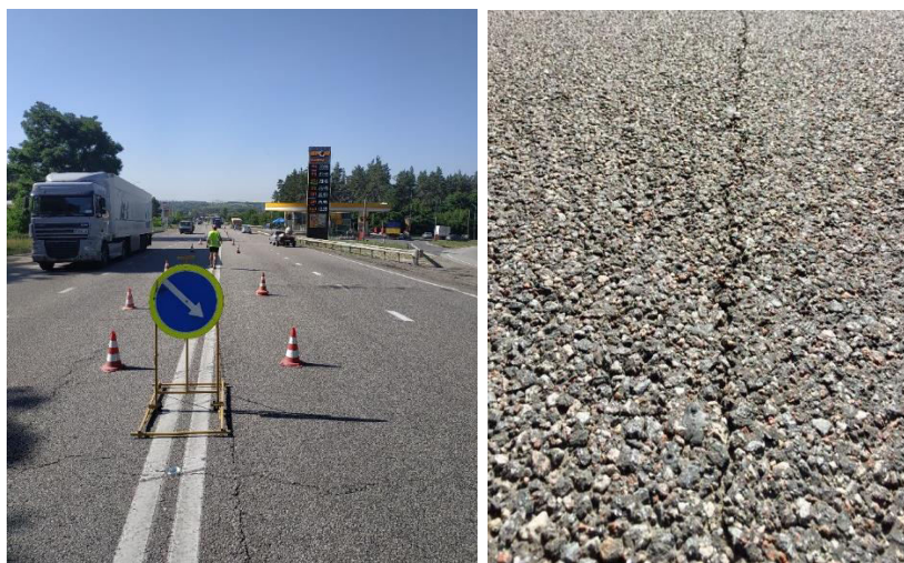
Рисунок 5.6 – Загальний вигляд поверхні асфальтобетонного шару покриття до початку виконання робіт з герметизації тріщин
