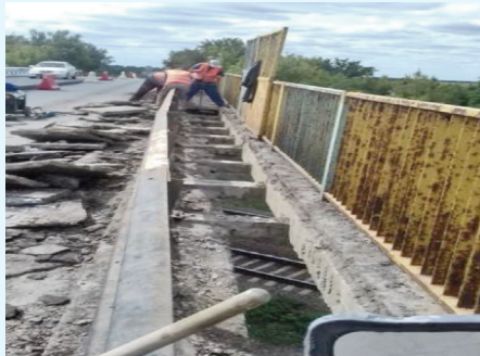
Руйнування тротуару на шляхопроводі на 23 км а/д Мерефа-Павлоград
